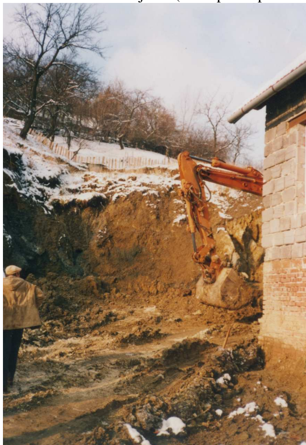
Foto 12 Okamžitá záchrana objektu (nebezpečí z prodlení)
