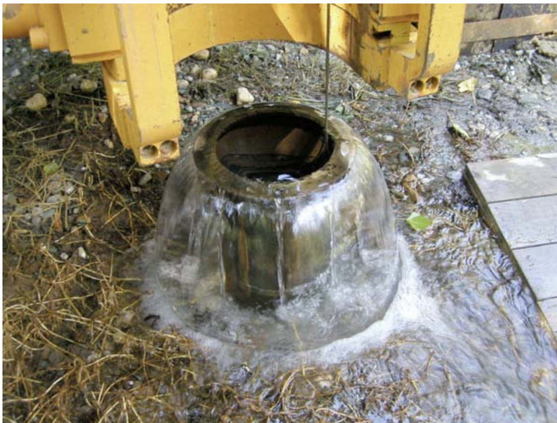
Obr. 3: Hydrogeologický vrt s kladnou úrovní piezometrické hladiny, která způsobuje přirozený přeliv (Skelná Huť – T. Charvát). Zhlaví tohoto vrtu je nutné tlakově uzavřít, případně ho zlikvidovat tlakovou cementací, protože trvale narušuje přirozené hydrogeologické poměry (požadavek zákonů 62/1988 Sb. a 254/2001 Sb. v platném znění).
