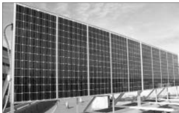
Fotovoltaický systém na střeše Elektrotechnické fakulty ČVUT v Praze
