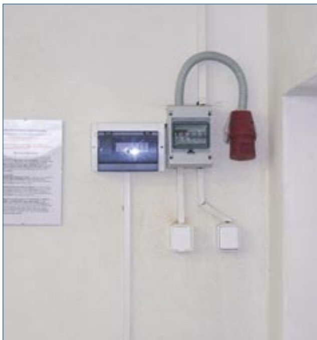
Obrázek č. 11 – signalizační zařízení pro případ úniku látek
