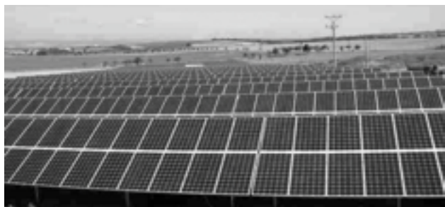
Celkový pohled na největší českou solární elektrárnu roku 2007 v Ostrožské Lhotě
