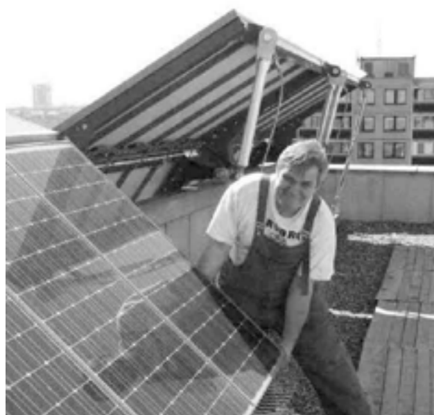
Sluneční elektrárna na střeše MŽP je výjimečná mj. konstrukcí výklopnou přes hranu budovy.
