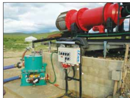
▲ Dekontaminační stanice instalovaná v technologickém centru u úložiště Bortolgoi.
